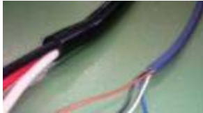
図5 ケーブルの変更 (左が既存ケーブル、右が変更したケーブル)
