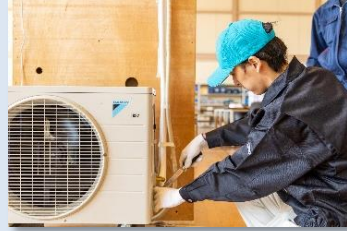
エアコン(空調設備)
