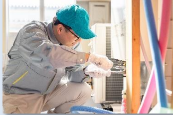
水道(給排水設備)
