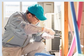
水道(給排水設備)
