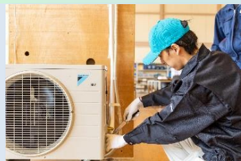
エアコン(空調設備)
