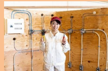
住宅電気配線
