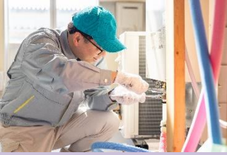
給排水衛生設備
