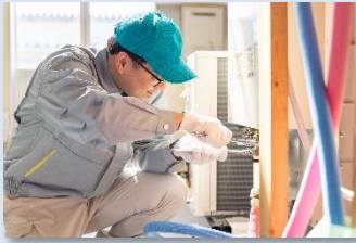
水道 (給排水設備)
