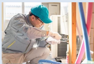
水道 (給排水設備)
