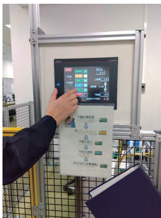
図 12 表示器の設置状況
