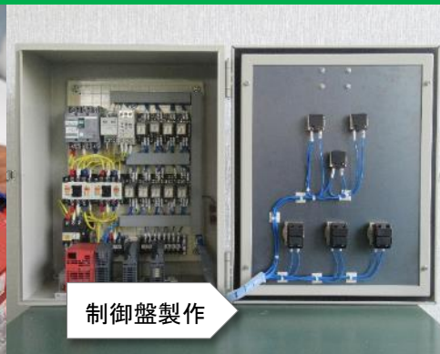
シーケンス制御(PLC)
