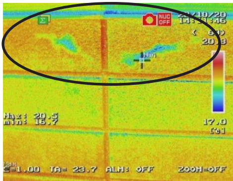
図 10 実験実習棟 1 階東面の赤外線画像
