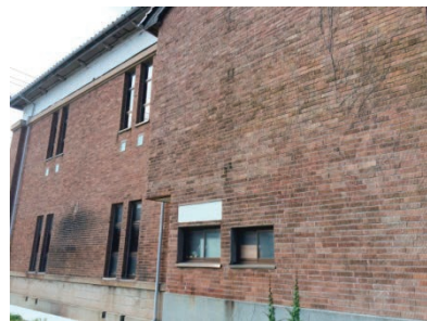
図 4-2 北面外壁の汚れの状況
