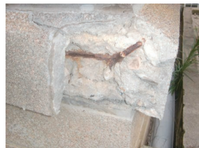
図 4-3 基礎部分の劣化
