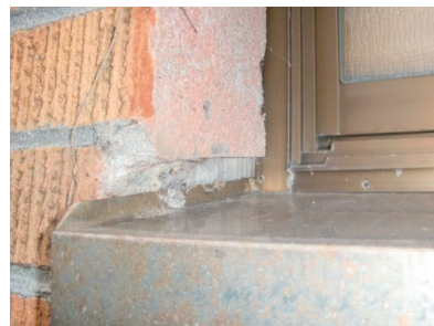
図 4-1 外壁スクラッチタイル破損箇所
