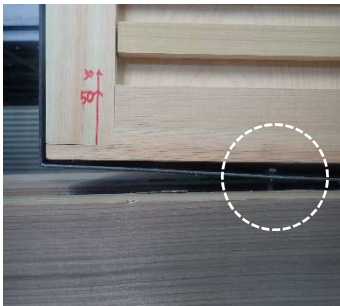
写真1 コーチスクリューの引抜け
