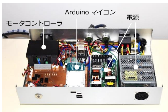
図8 コントローラ内部
