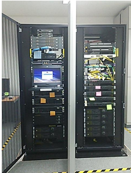
図 5 サーバーラック前面
