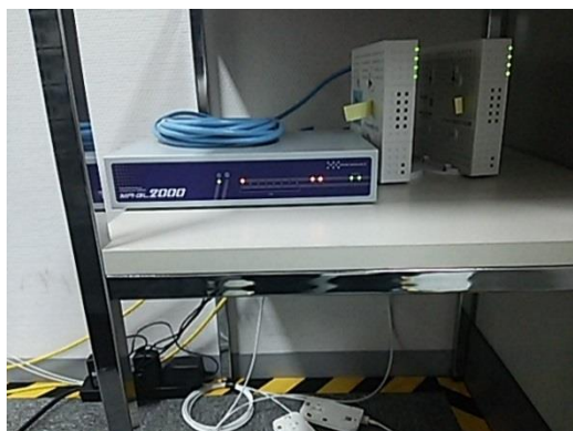
図2 インターネット接続機器
