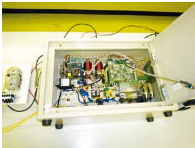
(b)パワーコンディショナ内部
