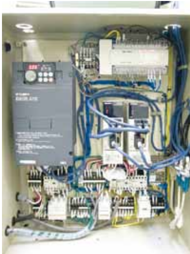
制御盤内部 (p48)
