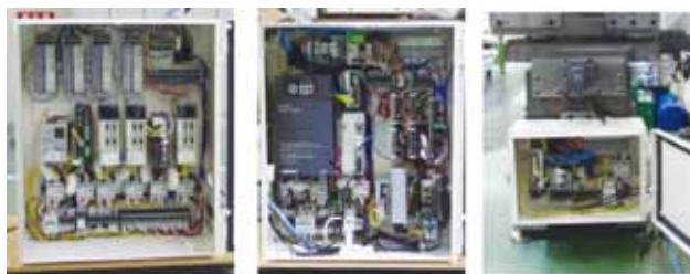
a) 100V 制御盤 b) 200V 制御盤 c) 工作機制御盤 図 28. 製作した制御盤
