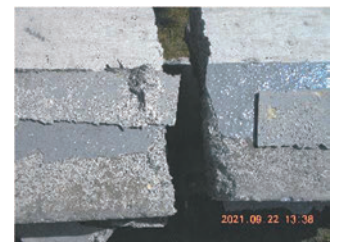
図18 無筋2破壊状況
