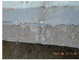
図17 無筋1破壊状況
