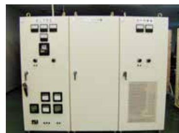
実習用受電設備
