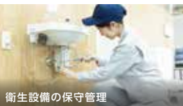
衛生設備の保守管理
