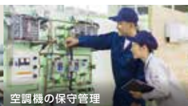
空調機の保守管理
