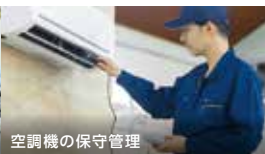
空調機の保守管理
