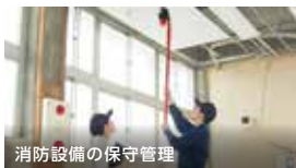
消防設備の保守管理
