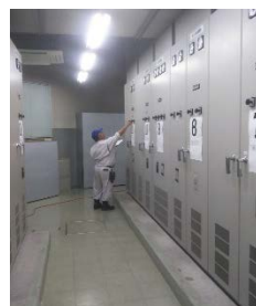
受変電設備点検
