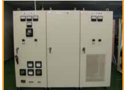
実習用受電設備
