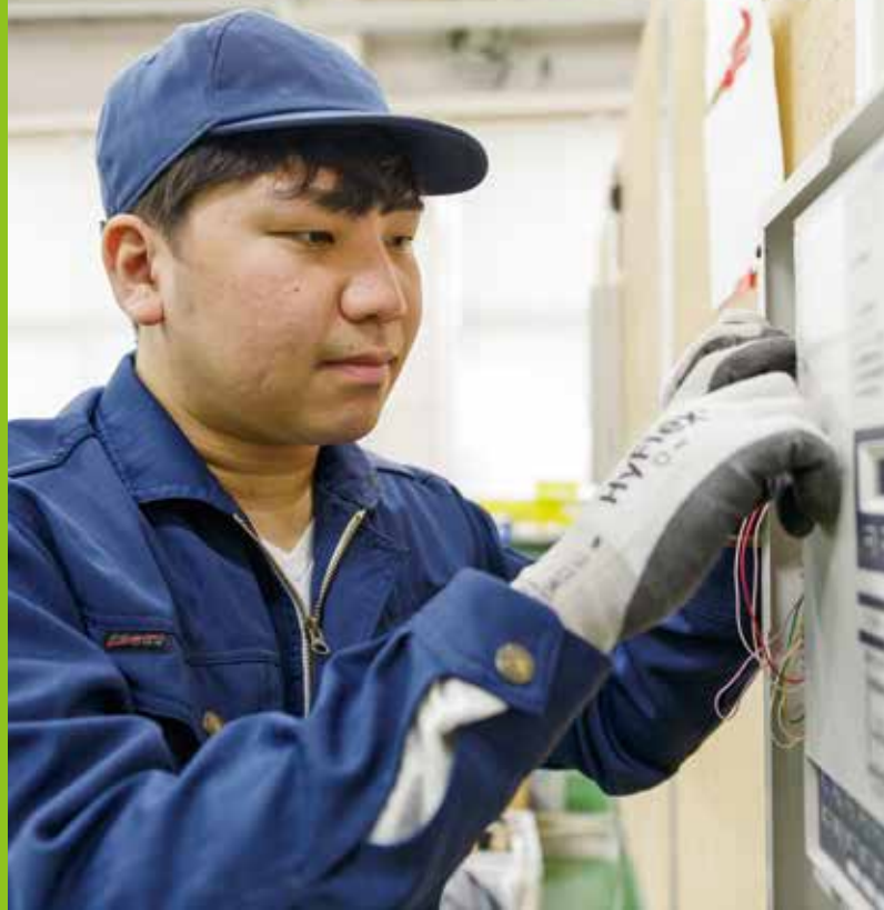
電気配線設備
