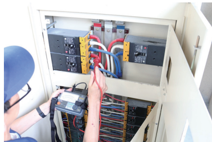
電気設備点検
