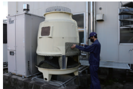
空調設備点検
