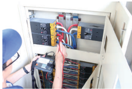
電気設備点検
