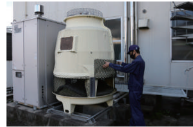
空調設備点検
