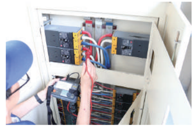
電気設備点検
