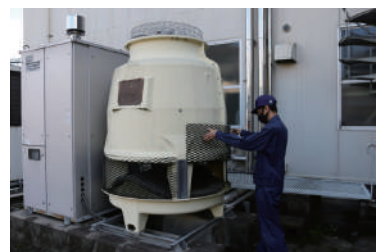
空調設備点検
