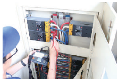
電気設備点検
