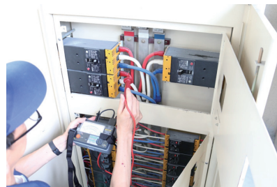
電気設備点検
