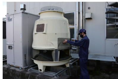
空調設備点検
