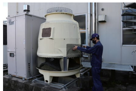
空調設備点検
