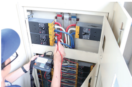
電気設備点検
