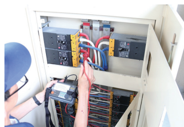
電気設備点検
