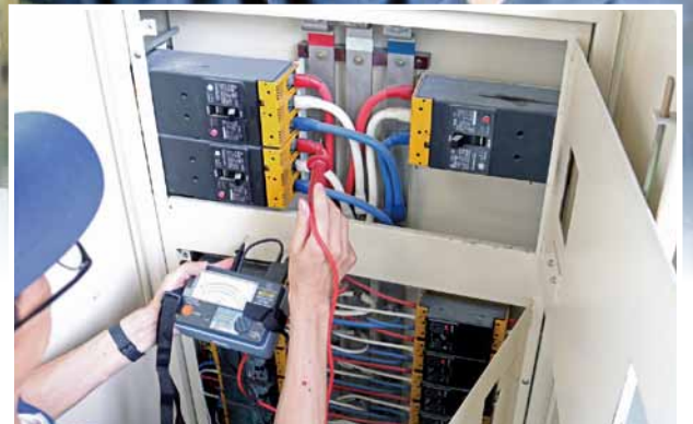
電気設備点検
