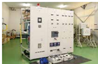
高圧受変電設備
