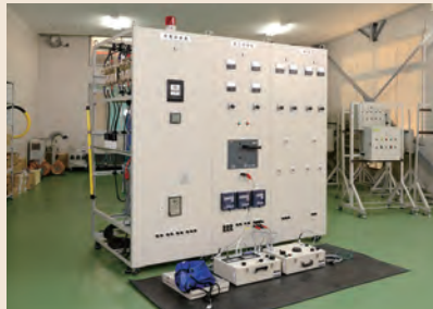
高圧受変電設備
