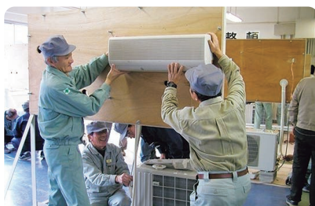
空調設備管理作業
