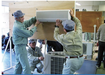
空調設備管理作業
