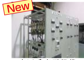
高圧受変電設備
