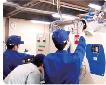
ボイラー運転実習
