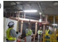
●大型民間物件の消防設備点検
