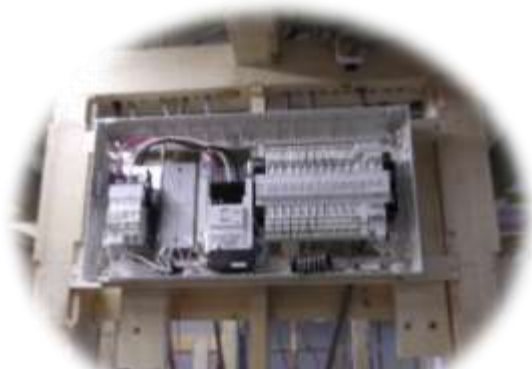
電気制御設備実習
