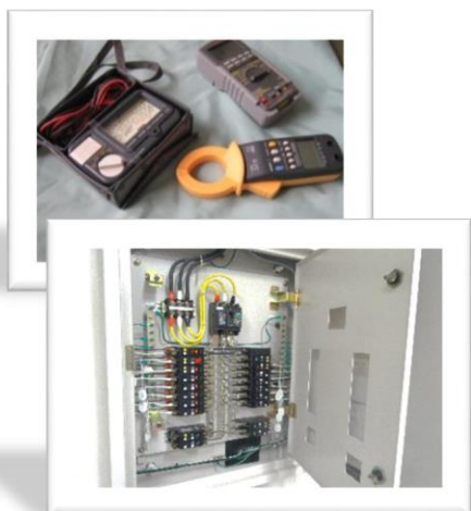
クランプメータ・制御盤など
