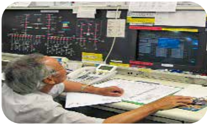
設備の運転状況を監視する仕事
