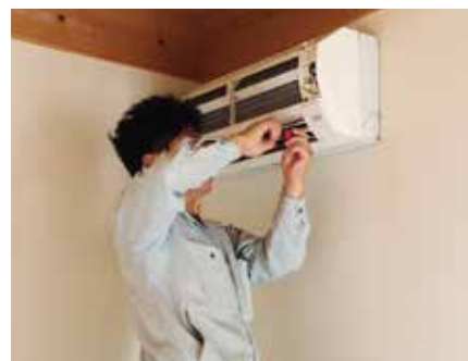
空調設備保全管理
