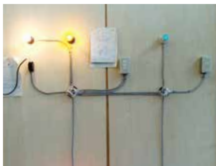
一般用電気設備工事
