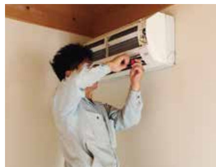
空調設備保全管理
