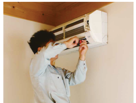
空調設備保全管理
