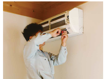
空調設備保全管理
