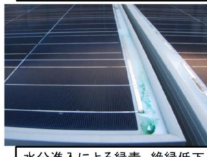
水分進入による緑青、絶縁低下
