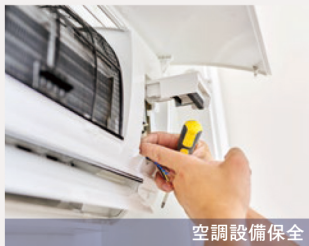
空調設備保全
