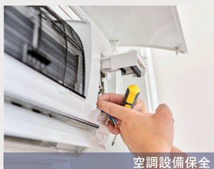
空調設備保全
